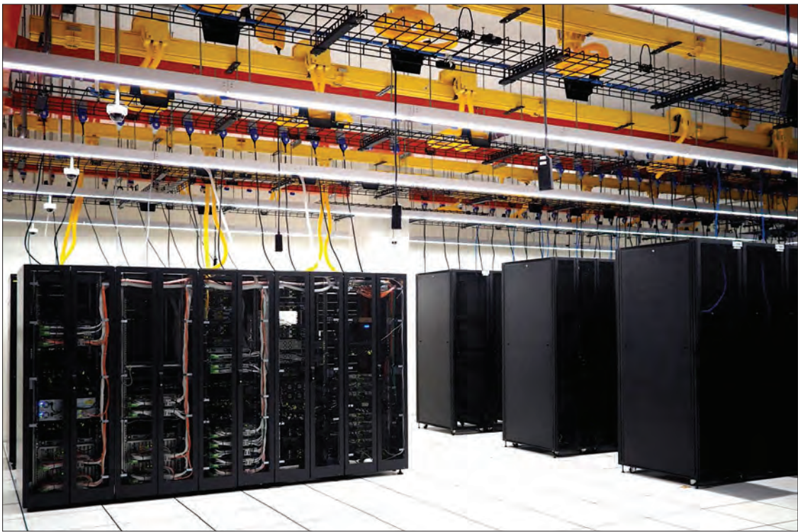
ရန်ကုန်မြို့ Data Center တစ်ခုအတွင်းရှိ Customer Racks များ တပ်ဆင်ထားမှုကို တွေ့ရစဉ်
