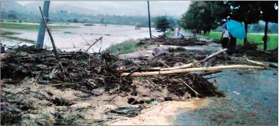
မိုင်းဆတ်-မိုင်းတုံ-မိုင်းပန်ကားလမ်း ရေကျော်ပျက်စီးနေမှုကို တွေ့ရစဉ်။
