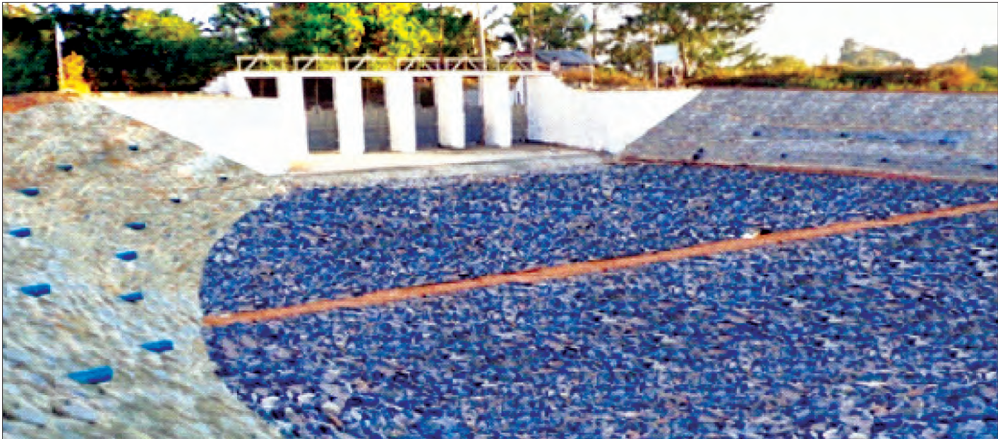
အင်းမအင်းရေလွှဲဆည်ရေတံခါး ခြောက်ပေါက်ရေတံခါးထိပ် ရေစားကမ်းပြိုမှုအတွက် ကျောက်ကြီးနံရံကာထားမှုကို တွေ့ရစဉ်
