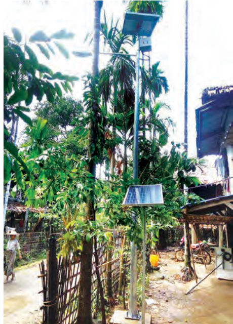
ရခိုင်ပြည်နယ်အတွင်းရှိ ကျေးရွာ များ၌ ဆိုလာစနစ်ဖြင့် မီးလင်းရေးလုပ်ငန်းများ ဆောင်ရွက်ထားသည်ကို တွေ့ရစဉ်။
