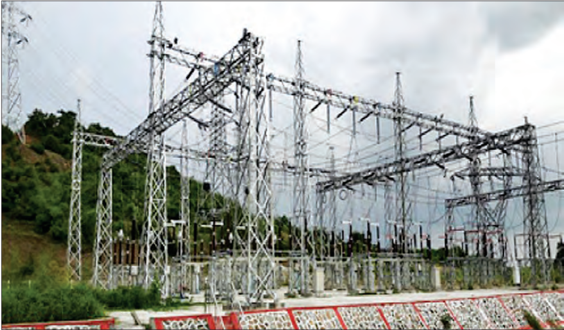
ပဲခူးတိုင်းဒေသကြီးအတွင်း ၂၃၀ ကေစီ တောင်တွင်းကြီး-ရွှေတောင် ဓာတ်အားလိုင်းနှင့် ဓာတ်အားခွဲရုံ Switch Bay တိုးချဲ့တည်ဆောက်ထားမှုကို တွေ့ရစဉ်။
