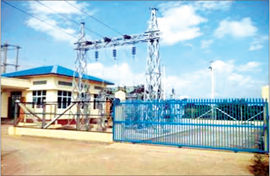
စဉ်ကိုင်မြို့နယ် ကျေးရွာပေါင်း ၁၄ ရွာအား လျှပ်စစ်ဓာတ်အားရရှိရေးအတွက် တည်ဆောက်ပြီးစီးသွားသည့် ၆၆/၁၁ ကေဗီ ၃ အမီဗွီအေ ခွဲရုံတစ်ရုံကို တွေ့ရစဉ်
