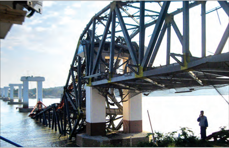
၂၀၁၂ ခုနှစ်က သပိတ်ကျင်းမြို့၌ ရစ်ချ်တာစကေး ၆ ဒသမ ၈ ငလျင်ကြီး လှုပ်ခတ်မှုကြောင့် ဆောက်လုပ်ဆဲ ရော့တီမြစ်ကူးရတနာသိမ်တံတား ပြိုကျပျက်စီးခဲ့မှုအား တွေ့ရစဉ်
