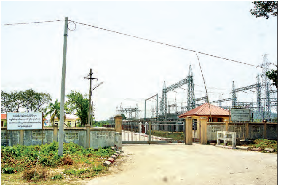
ကျောက်ဖြူဓာတ်အားခွဲရုံကို တွေ့ရစဉ်
