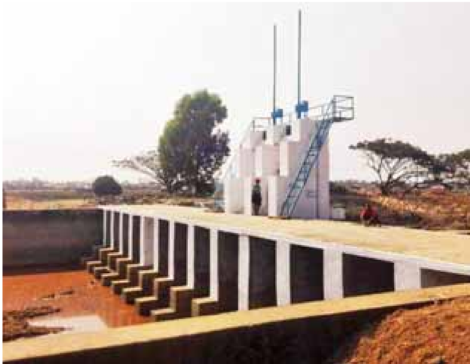
ကျိုက်ထိုမြို့နယ် ကဒတ်ချောင်း ရေတံခါးတပ်ဆင်ထားမှုကို တွေ့ရစဉ်။
